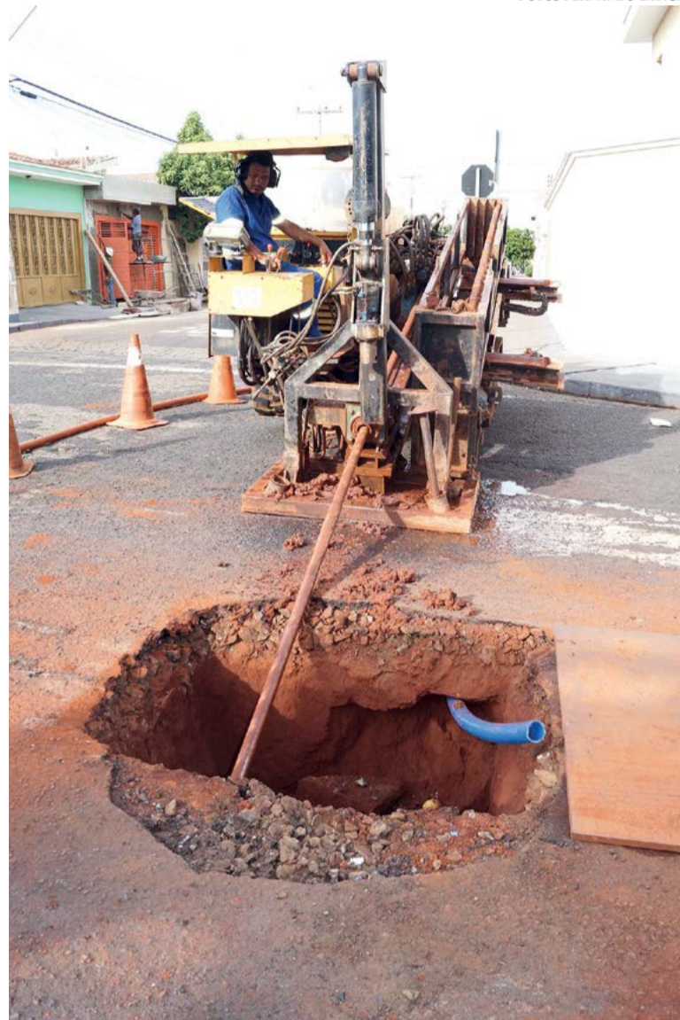
Método não destrutivo de obra do Daerp chega na rua Constituição. Estão sendo instalados 1.800 metros de polietileno de alta densidade de uma nova rede de água. A antiga será abandonada. Este sistema evita a abertura de valetas, que prejudicam o trânsito e danificam o asfalto
