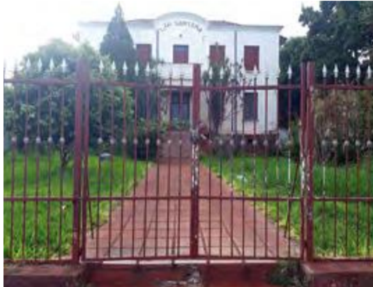
Portão de entrada quebrado, preso com uma corrente
